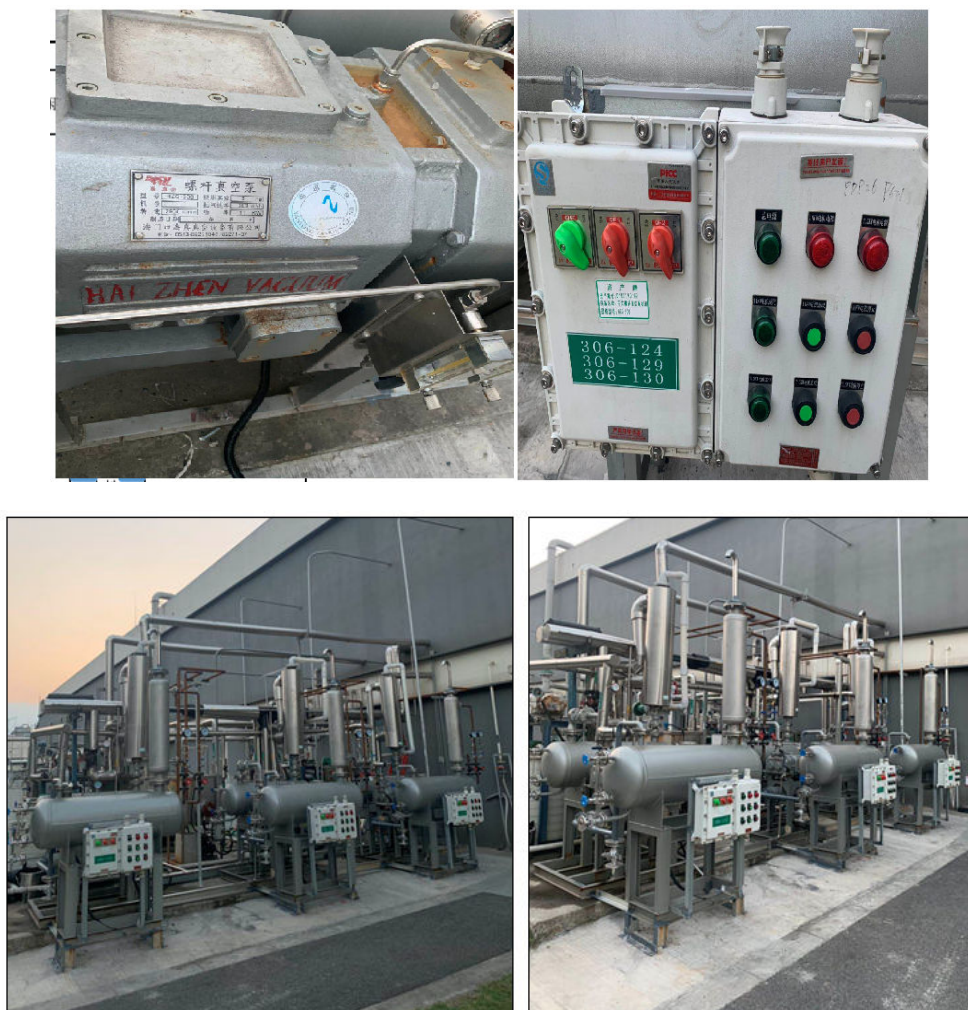
图 7.3-1 真空泵改螺杆泵方案实施后现场照片
